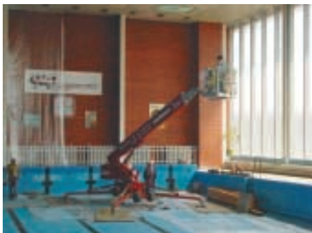
Der Narrow DL22N konnte bis auf den Beckenboden rangiert und in Position gebracht werden.
